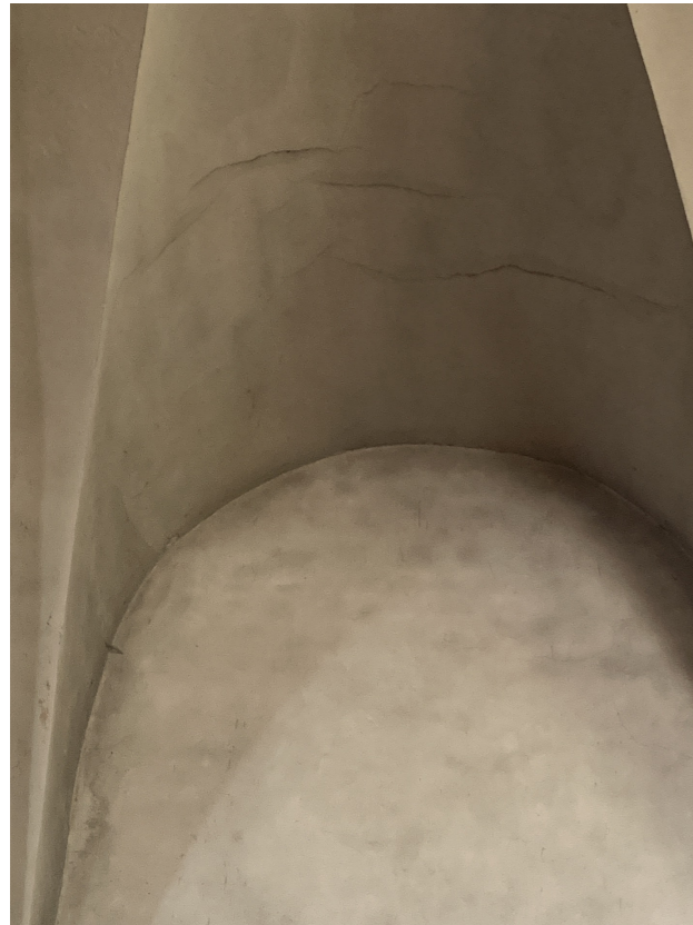
MICRO-FISSURES - AGENCE C. REMOND - AVRIL 2020
