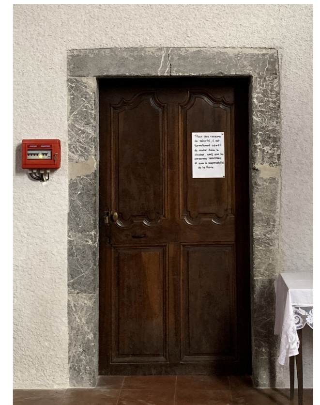
PORTE D'ACCÈS A LA SACRISTIE - JOINT CIMENT - AGENCE C. REMOND - AVRIL 2020
