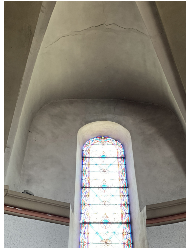
FISSURE VOÛTAIN- AGENCE C. REMOND - AVRIL 2020
