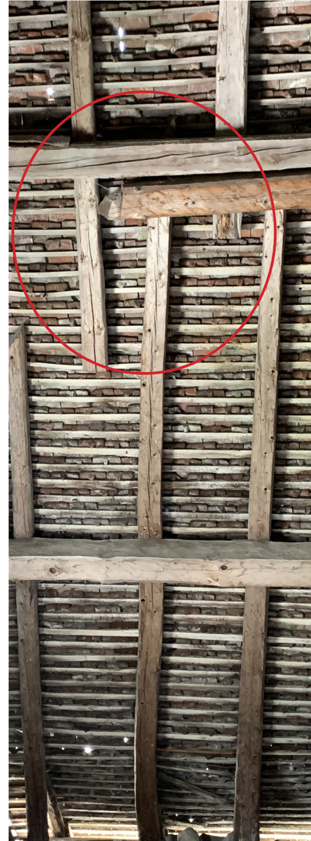
DISCONTINUITÉ CHEVRONS ET PANNE SUPÉRIEURE - 1ERE TRAVÉE NORD - AGENCE C. RÉMOND - AVRIL 2020
