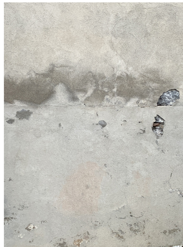
LIMITE ENTRE ENDUIT - AGENCE C. REMOND - AVRIL 2020
