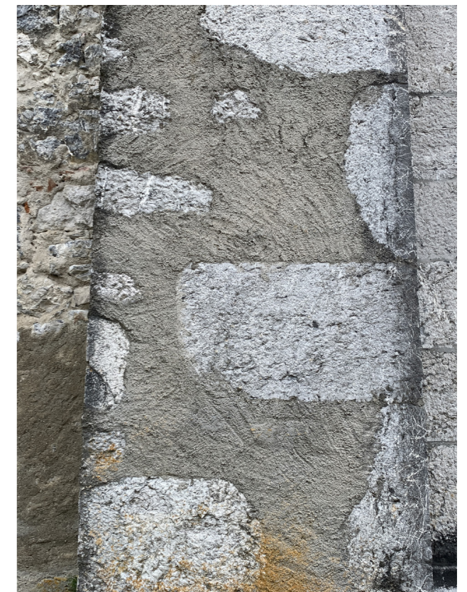
JOINT CIMENT DU CONTREFORT - AGENCE C. REMOND - AVRIL 2020
