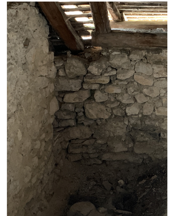
APPUI SUR SABLIERE DÉFAILLANTS / PIERRES DÉJOINTÉES / FISSURE - 1ER TRAVÉE NORD - AGENCE C. RÉMOND - AVRIL 2020
