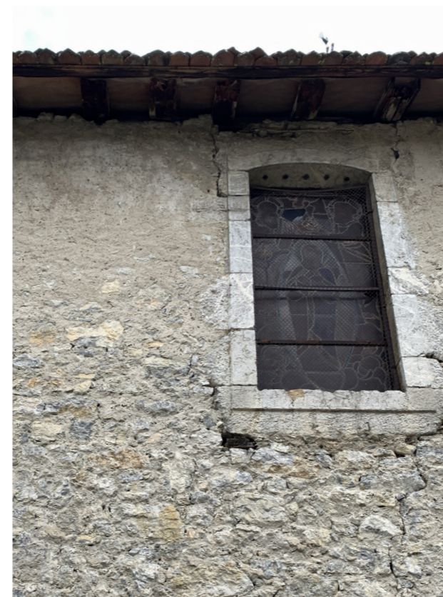
FRACTURE DES PIERRES ET FISSURES - AGENCE C. REMOND - AVRIL 2020
