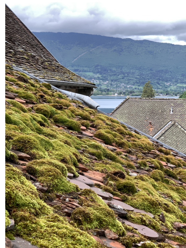
MOUSSES SUR TOITURE - AGENCE C. REMOND - AVRIL 2020
