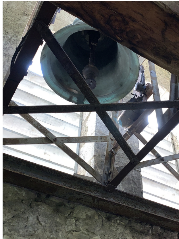
TACHES DE CORROSION - AGENCE C. REMOND - AVRIL 2020
