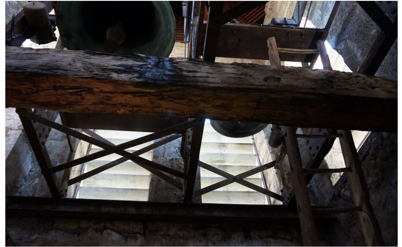
VUE DE L'INTÉRIEUR DU CLOCHER, LES CLOCHES ET LES ABAT-SONS - PHOTO AVRIL 2019, CR
