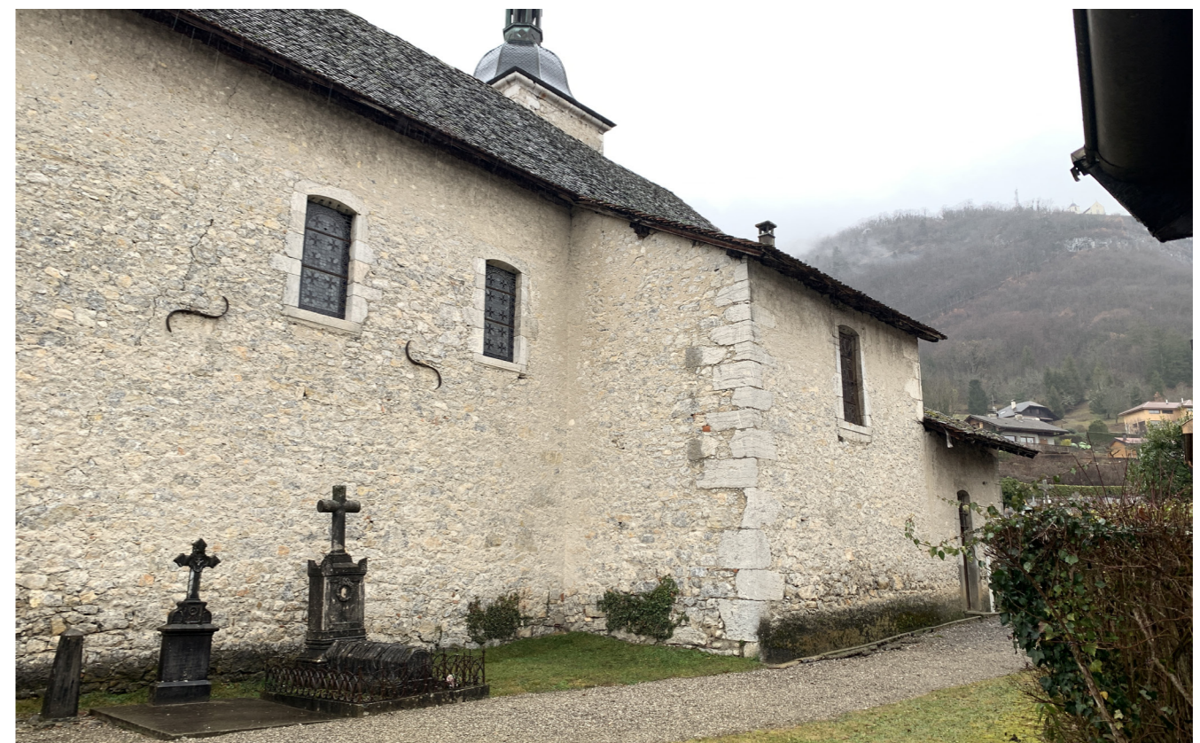
PHOTO DES DÉSDORDRES LIÉS À L'HUMIDITÉ ET AUX ÉCARTEMENTS DES MURS - AGENCE C. RÉMOND - JANVIER 2020
