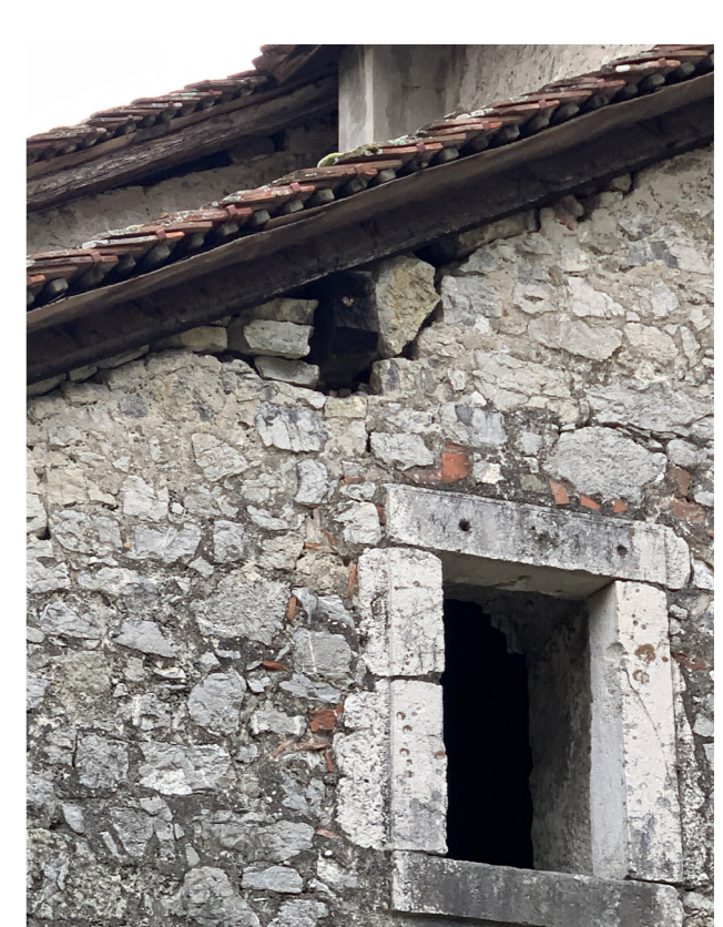
ARASE INSTABLE ET BAIE SANS FERMETURE - AGENCE C. REMOND - AVRIL 2020
