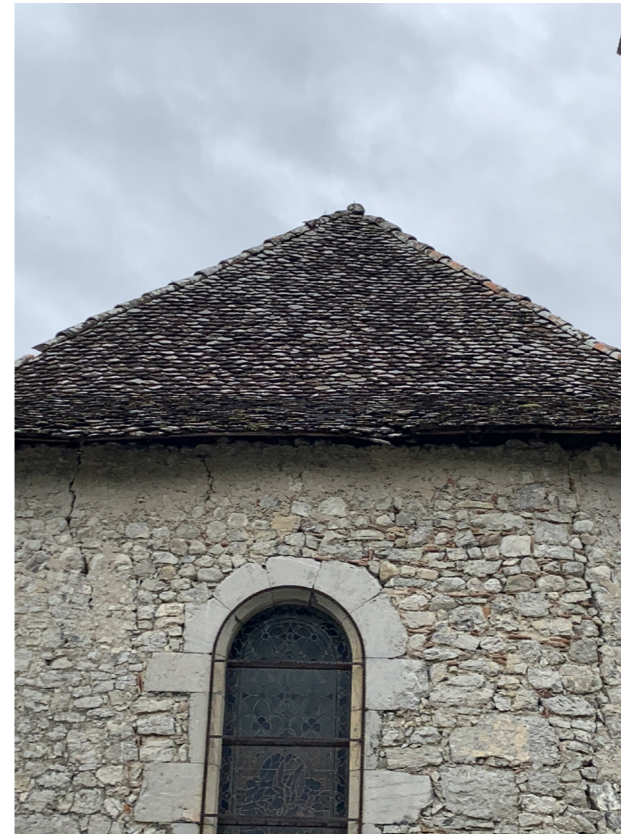
FISSURES - AGENCE C. REMOND - AVRIL 2020
