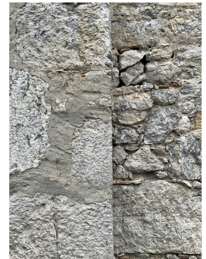
JOINT CIMENT ET JOINT DÉGARNIS - AGENCE C. REMOND - AVRIL 2020
