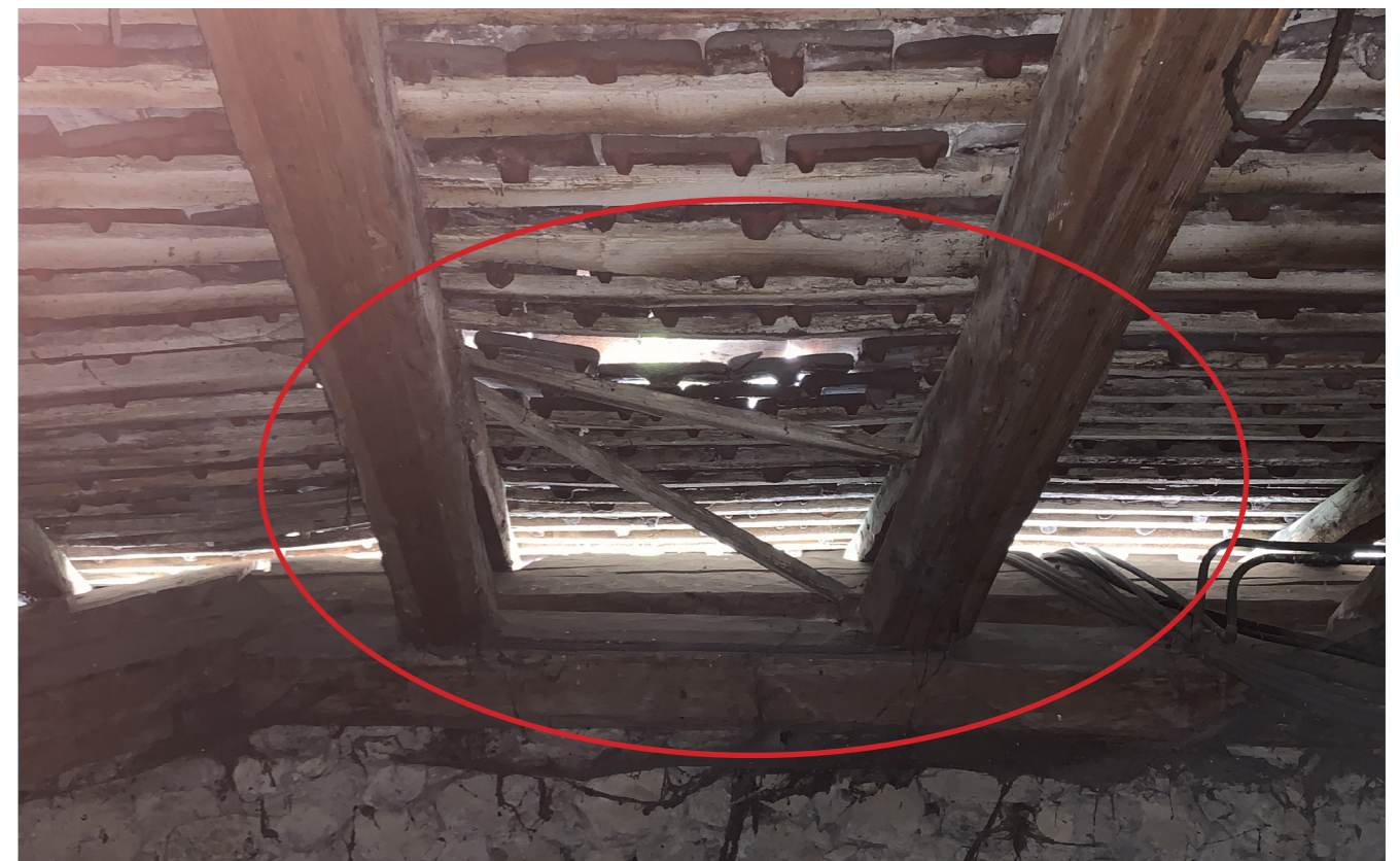
TOITURE EN MAUVAIS ÉTAT - CHEVET - AGENCE C. REMOND - AVRIL 2020
