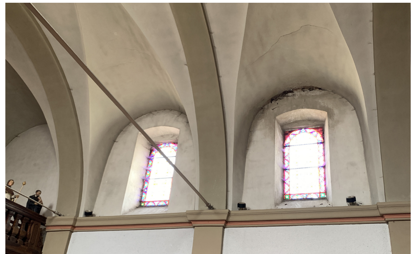
FISSURES , TIRANT, INFILTRATION D'EAUX - 2EME ET 3EME TRAVÉES NORD - AGENCE C. REMOND - AVRIL 2020
