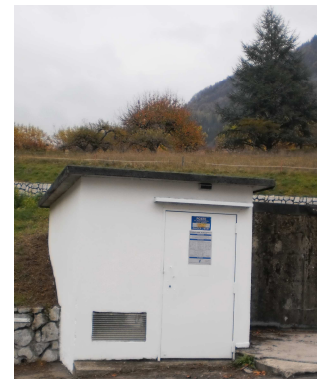
Peinture transformateur edf suite à des graffitis
